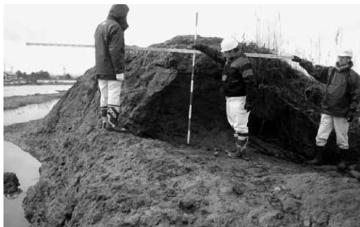
堤防被災状況 3/19 (二級河川七北川右岸堤防 仙台市蒲生地区)
